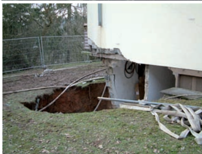
Abb. 1: Gebäudeschäden nach einem Erdbeben (o.) und Tagesbruch (u.)
